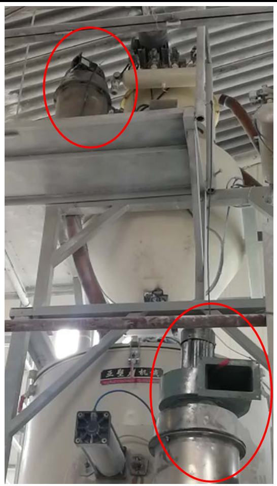
搅拌机 2 处除尘装置
