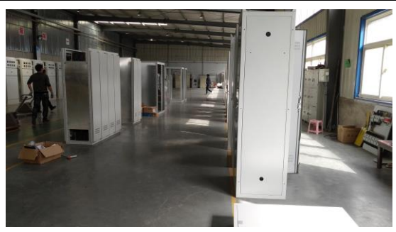
配电柜组装区
