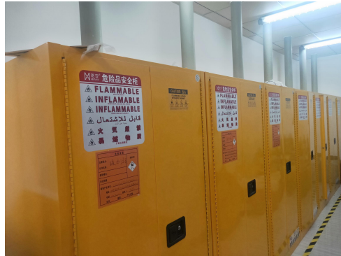
危废暂存间内专用收集柜及废气收集管道
