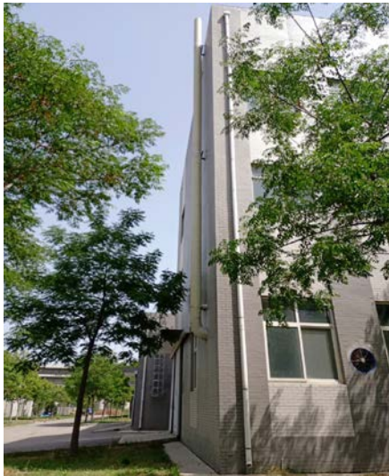
B 系列细格栅及曝气沉砂池排气筒
