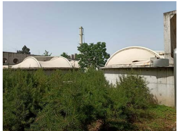
A 系列污泥浓缩池及排气筒
