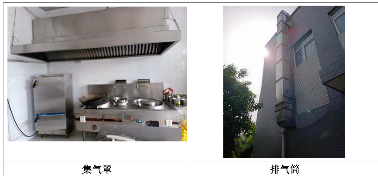
图 1-10 现有工程油烟废气处理措施
