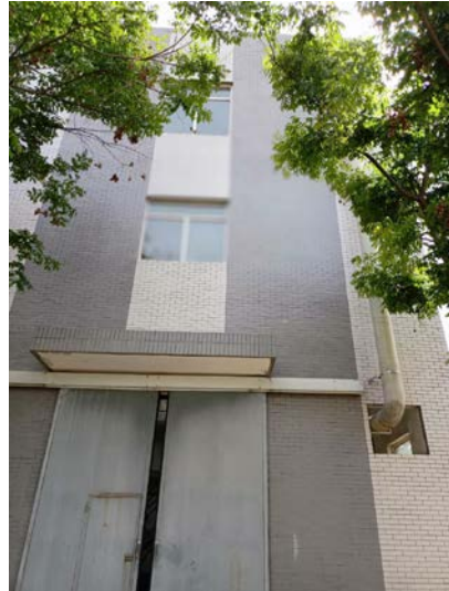
A 系列细格栅及曝气沉砂池排气筒
