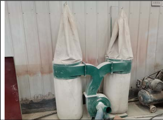
双桶除尘器现状
