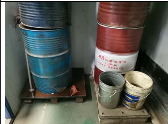
危废暂存间现状 (1)
