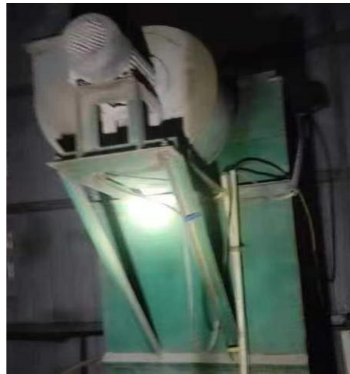
干粉散装库脉冲布袋除尘器
