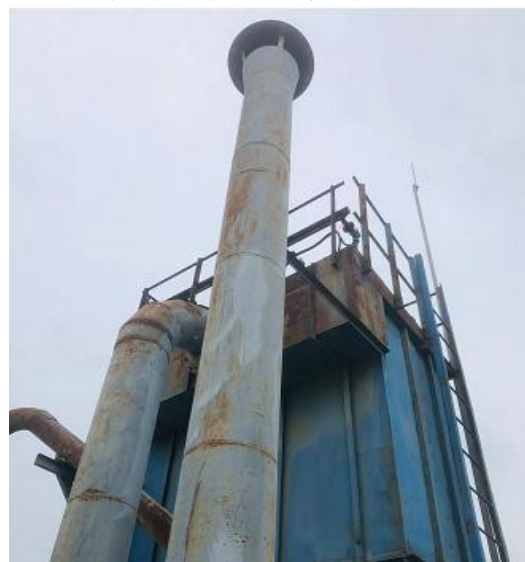
干砂库废气排气筒
